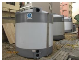
工業用純水槽
