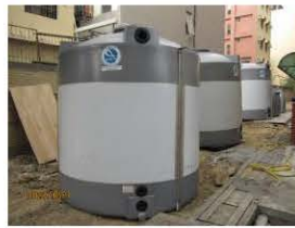
工業用純水槽
